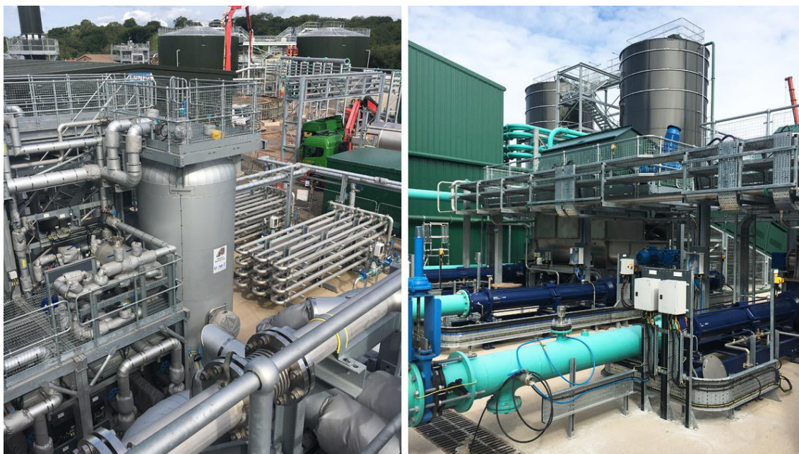
図2 THPプラント（左）及び持ち込み汚泥搬送システム（右）
