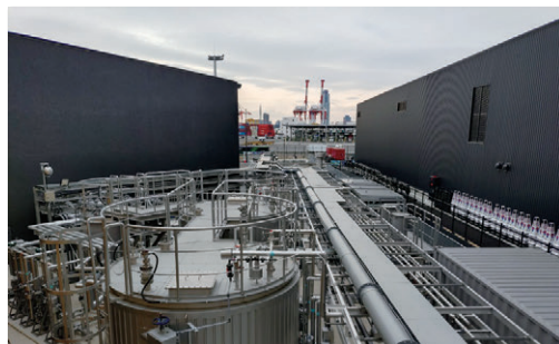
バイオガスプラント
