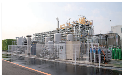
実証設備全景（提供：大阪ガス）
