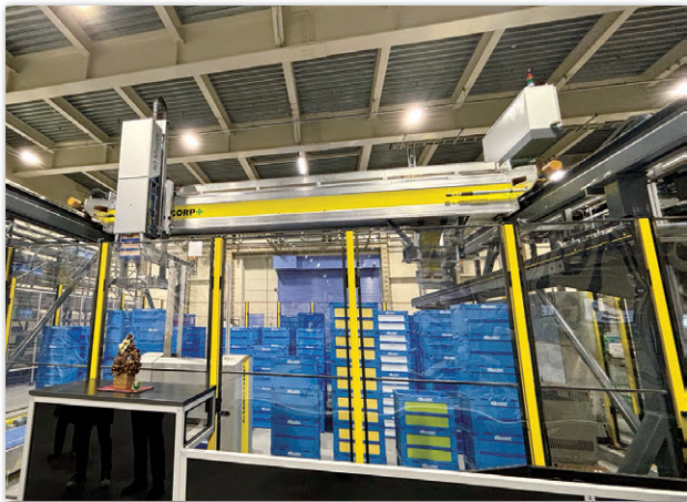
写真6 ガントリー式ロボット搬送システム
