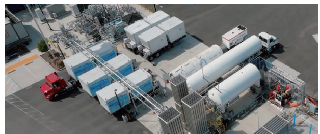
写真2 水素供給設備
