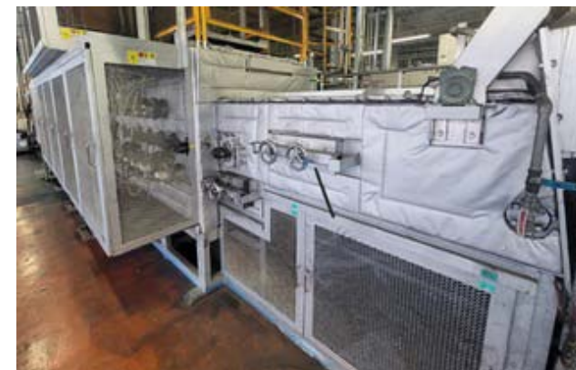
■ Pic.9 断熱ジャケット
