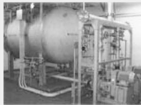
建屋型真空ステーション
