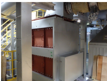
写真-1 消石灰充填槽
