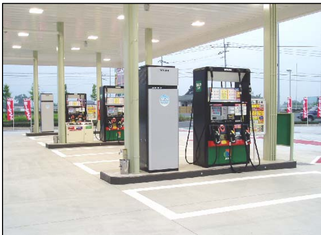
図 2-6 ガソリン給油所設置 (給油機)
