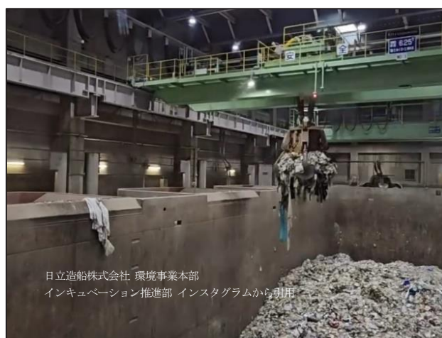
図表 1 ごみ焼却発電施設のごみクレーン
