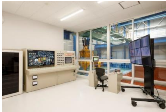
図表 16 ごみクレーン操作室
