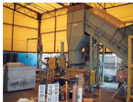
Pic.9 廃プラ圧縮機
